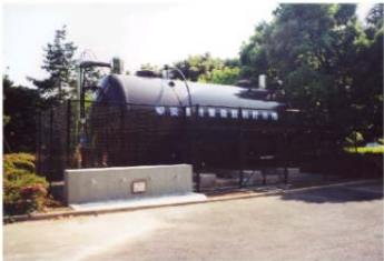
飲料用貯水槽 (園内3カ所、各タンク50トﾝ)
