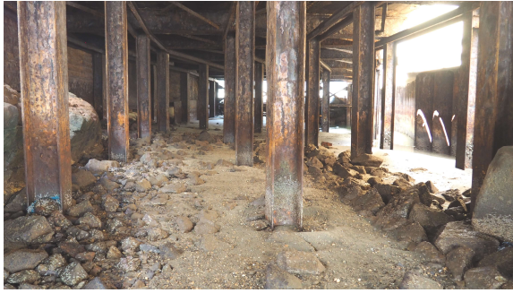
図 8 西側：仮設構台の下 擁壁（左側）の海側を覆っていた法面盛土の崩壊に由来する砂浜 撮影：2019.8.15
