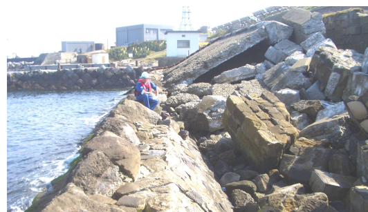
図 6 西側：間知石護岸背後の法面の崩落状況 撮影：2014.10.20
