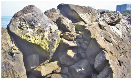
図 3 西側：間知石護岸の西端部 波浪による崩壊 撮影：2014.10.20
