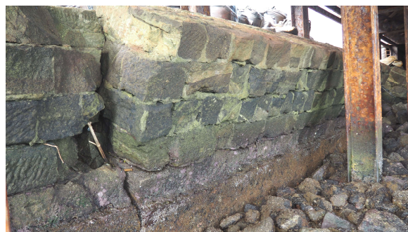
図 18 西側：仮設構台の下 海側に傾く石積擁壁 撮影：2019.8.15
