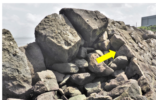
図 4 西側：間知石護岸背後の粗石積み 波浪による西端部の崩壊の進行 撮影：2019.8.15
