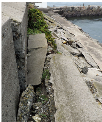
図 35 東側：犬走のコンクリートスラブがアーチ状の石積み擁壁の頂部に直接載っている 撮影：2018.9.7
