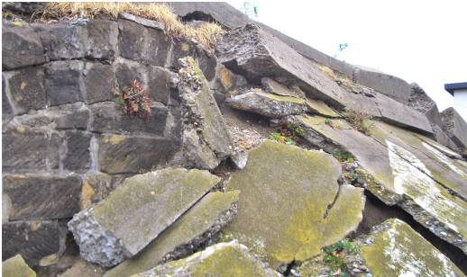
図 21 東側：被覆コンクリートの崩壊により、擁壁が露出 撮影：2014.2.13
