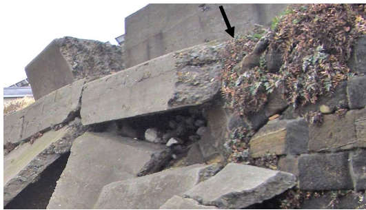
図 34 東側：パラペットが擁壁に直接載っている 撮影：2014.2.13
