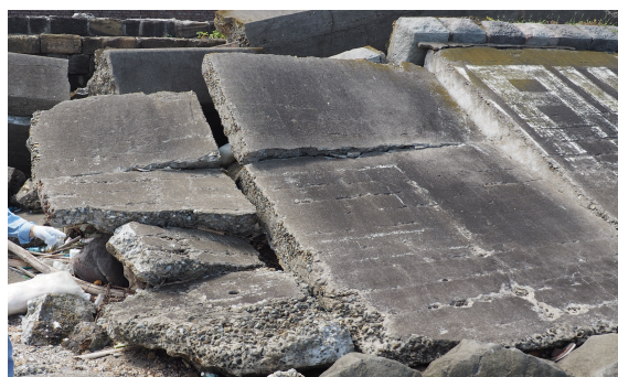
図 29 中央：法面被覆コンクリート：打継ぎ目に沿って崩落 撮影：2019.8.15
