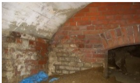
図 14 西側：仮設構台と並行する掩蔽壕の内部 土砂が流入・堆積している 撮影：2014.11.7
