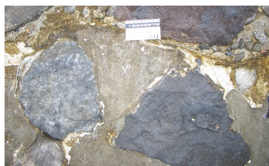
図 7 粗石積みの間詰めコンクリートの表層モルタル 撮影：2014.11.7
