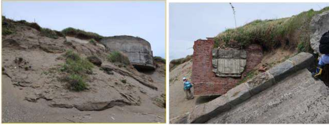
左翼第3砲台（覆土が地すべり状に崩壊）
